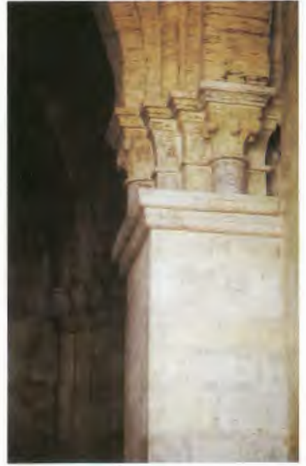
Contrafuertes del muro septentrional de la iglesia aprovechados como pilares capilla de San Benito, s. XII).
